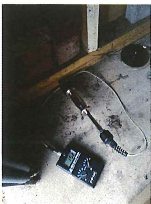
Garage 8: Fuktvärde 15,0% fk
