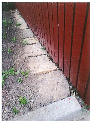
Garage 8: Rötskador i träpanel.
