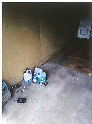
Garage 3: Mikrobiella skador på gipsen.
