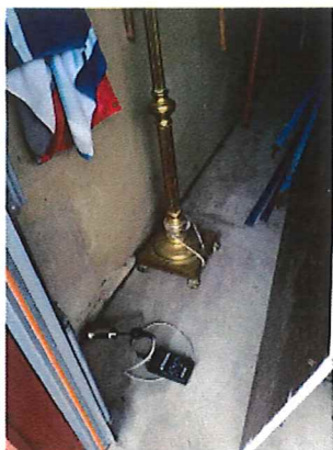
Garage 5: Mikrobiella skador på gipsen.
