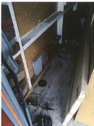
Garage 8: Ingen gips på gavelväggen.
