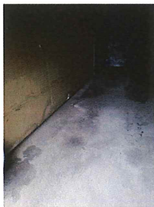
Garage 1: Mikrobiella skador på gipsen.
