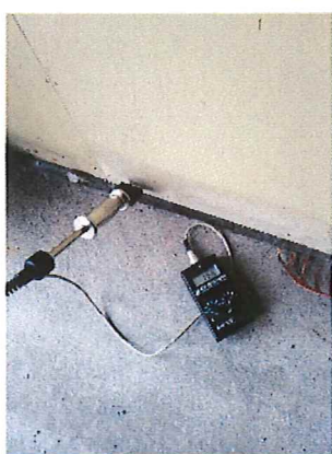
Garage 4: Fuktvärde 18,7% fk
