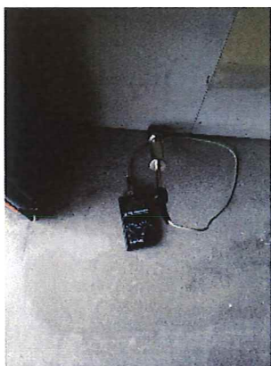
Garage 6: Fuktvärde 20,0 %Fk.
