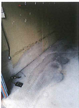
Garage 6: Mikrobiella skador på gipsen.
