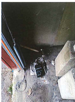
Garage 2: Fuktvärde 13,6%fk
