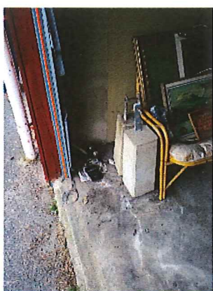
Garage 2: Mikrobiella skador på gipsen.
